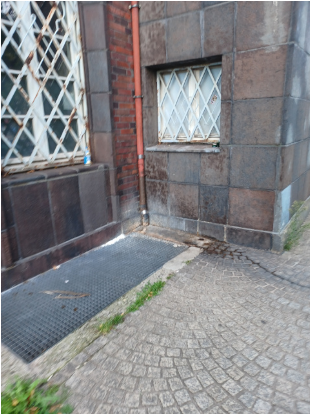
Bild 2: Geht man in den Zwischenraum zwischen Parkplatz und Seiteneingang hinein, erkennt man an der ersten Gebäudekante Spuren von Urin an der Wand und getrocknete Fäkalien auf dem Boden.
